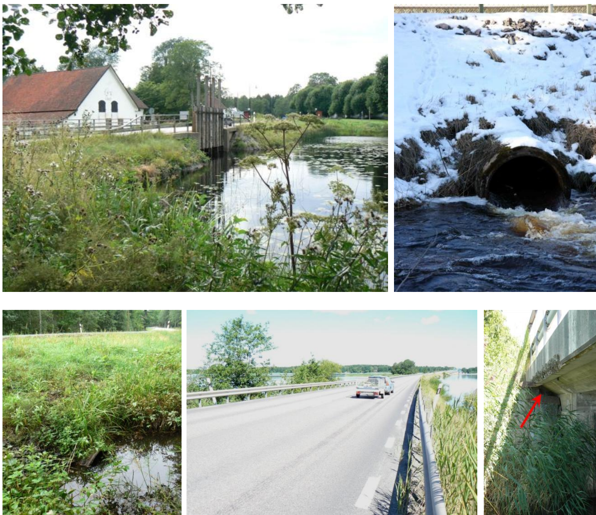
Figur 3. a) Exempel på damreglering i samband med en bro, b) vägtrumma med hög strömningshastighet, c) översvämmad vägtrumma (bilden är tagen vid lågvatten), d) vägbank tvärs sjö med bro i ena kanten, e) markeringsplats under kantbalken. Foto: J Arrendal, MyraNatur.
